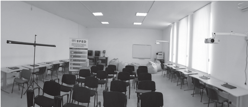
Рис. 3. Вигляд ICR після ремонту та встановлення обладнання, 2020 р. (частина обладнання не встановлена)
