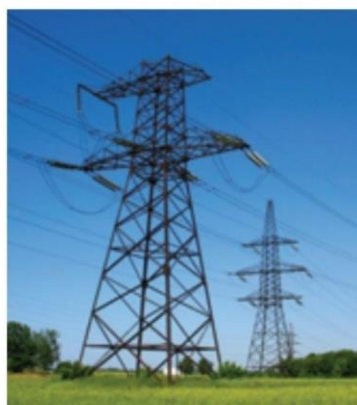
Опори ліній електропередачі
